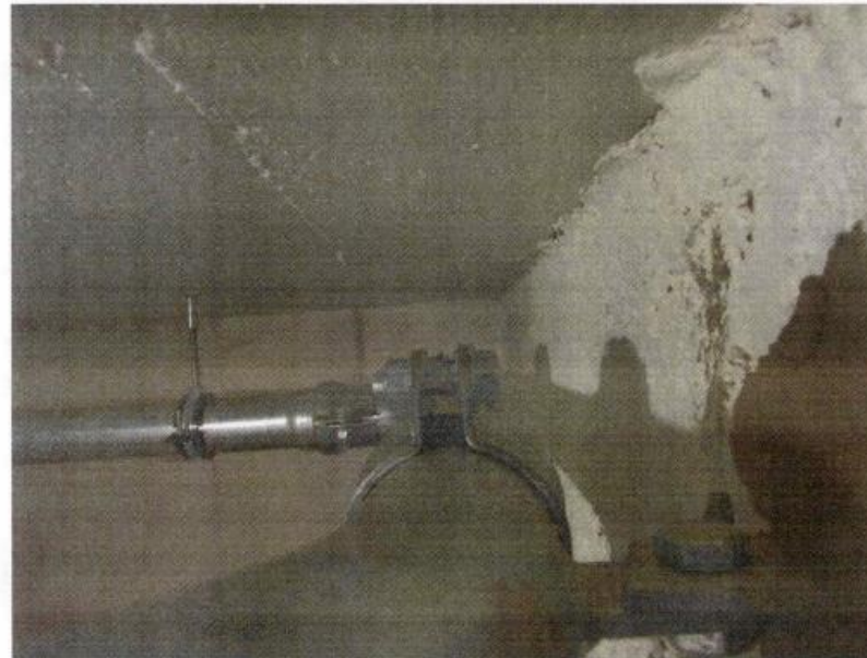
: Abstand Maueranker zu Schraubmuffe, kein Platz für einen 2. Anker vorhanden
