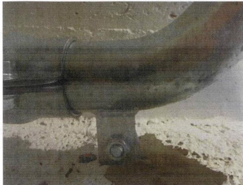
: Abstand Maueranker zu Schraubmuffe, kein Platz für einen 2. Anker vorhanden
